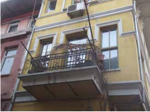
Fotoğraf 7 - 2307 ada 28 parseldeki yapının restorasyon sonrasındaki durumu (Kaynak: Dinler, 2013) / The after-restoration situation of the building on the building block 2307 the building lot 28 (Source: Dinler, 2013)
