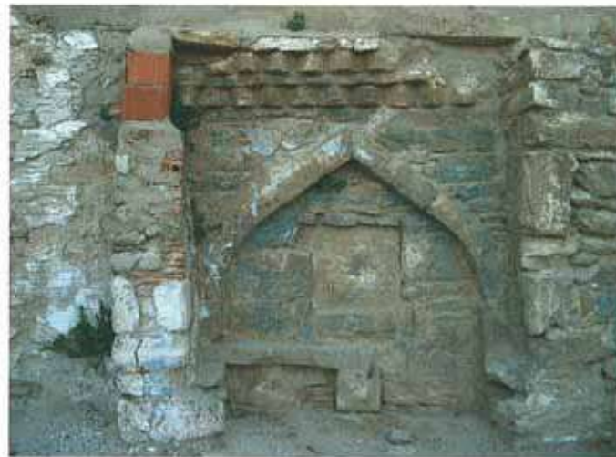
Res. 23. Depremde hasar görmüş duvar (env. no: L21B1014), Karşıyaka Mahallesi.
