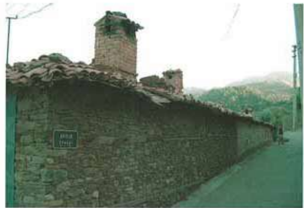
Res. 22. Aynı evin (env. no: L21B1227) yan cephe duvarı ahşap hatıllı yığma taş duvar örgüsüne örnek.
