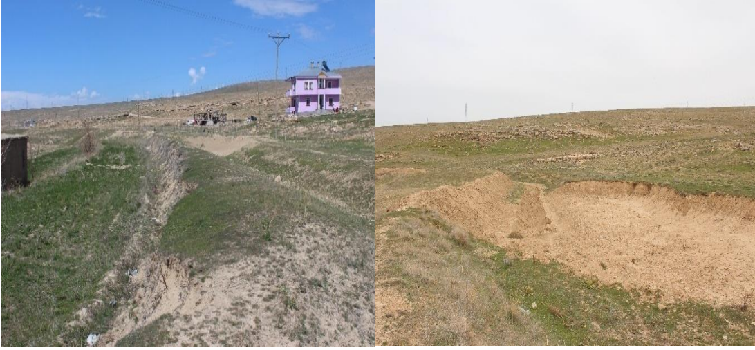
Şekil 7. Kanal içinde genişletme çalışmaları sonucu oluşan tahribat. Sağ: kanalın dış eğiminde oluşan tıraşlama tahribatı (Orijinal, 2019).
