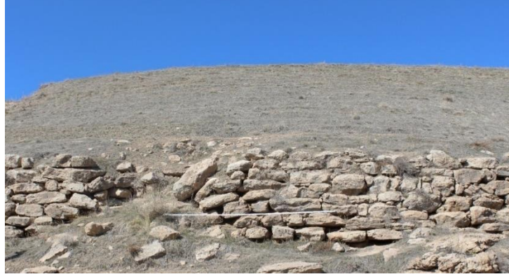
Şekil 4. Toprak kayması nedeniyle istinat duvarında meydana gelen tahribat (Orijinal, 2019).
