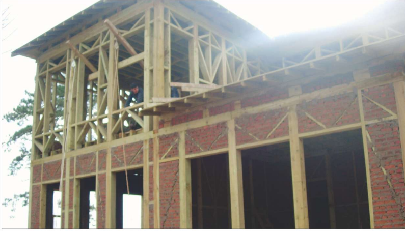
Res. 22a. A yapısının zemin ve birinci katında ahşap karkas sistem arası harman tuğlası uygulaması
