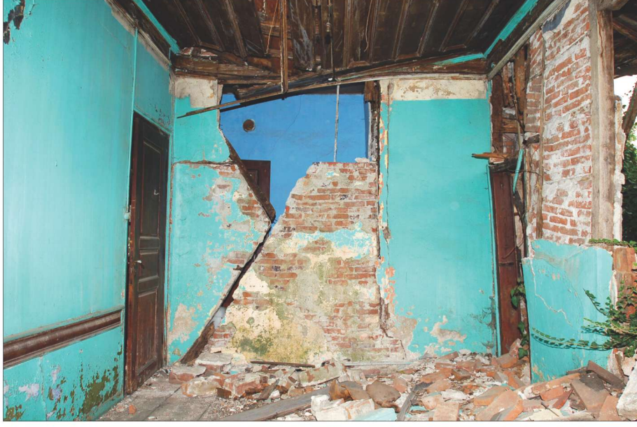
Res. 16. Hamam mekanının yıkılmış duvarları (P.Kapar, 2006)
