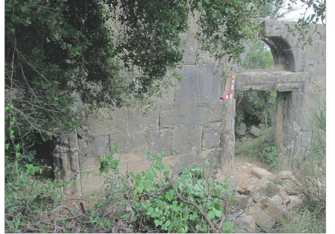
Fotoğraf 32 - Sumbas, Karapınar- Işıklı Kilise batı görünüşü / Sumbas, Karapınar- Işıklı Church, view from west
