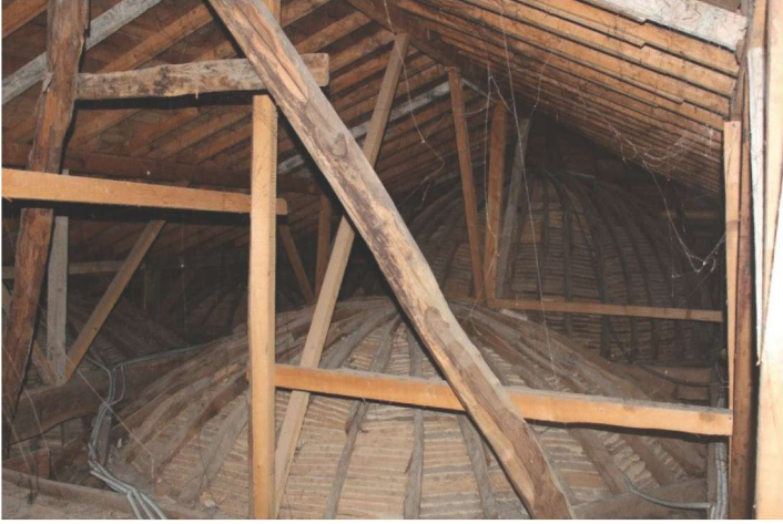
Fotoğraf 5 – Bağdadi kubbelerin çatı makasları arasına yerleştirilişi (Mukaddes Ataman) / The placement of the bağdadi dome in-between the roof trusses (Mukaddes Ataman)
