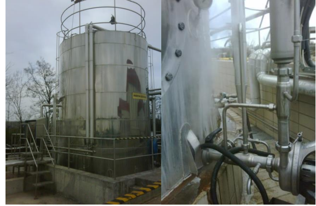
Şekil 5. Hindistan cevizi yağı depolama ünitesi
