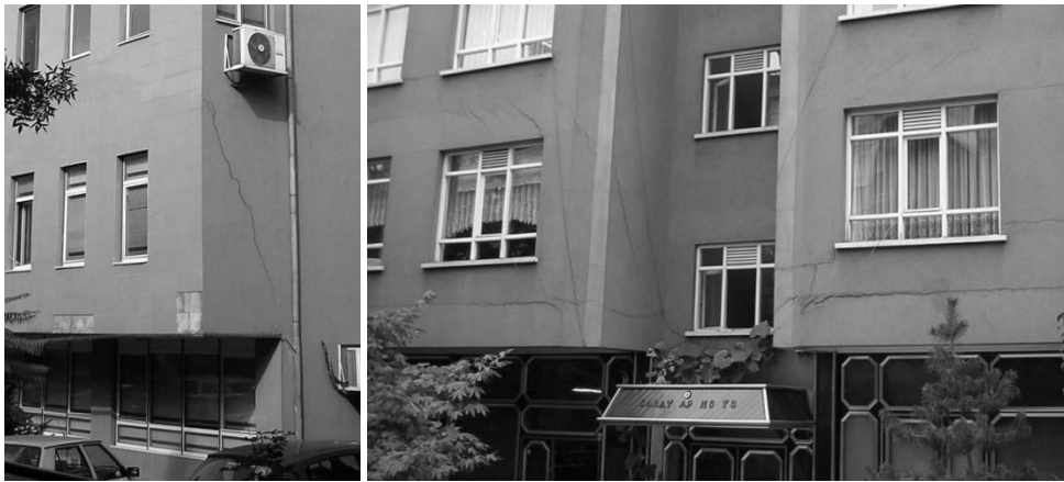
Şekil 2. Konsol kirişe oturan dolgu duvarlarda oluşmuş çataklar (iki ayrı bina)
