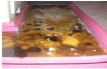
Şekil 4. Kirlenen Soğutma Haznesi (Contaminated Oil Sump) (Demir, 2009)
