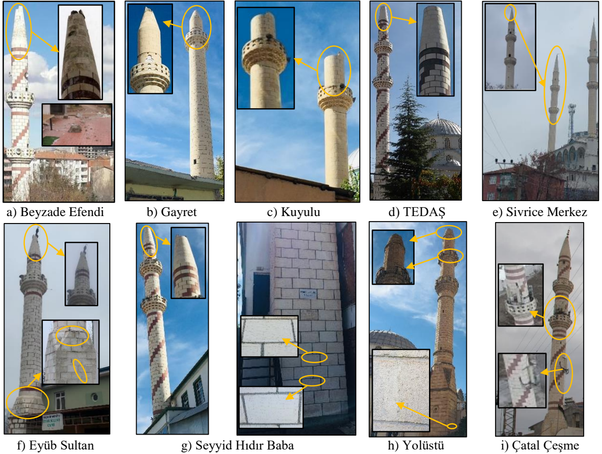
Şekil 9. Deprem sonrasında minarelerde meydana gelen hasarlara örnekler
