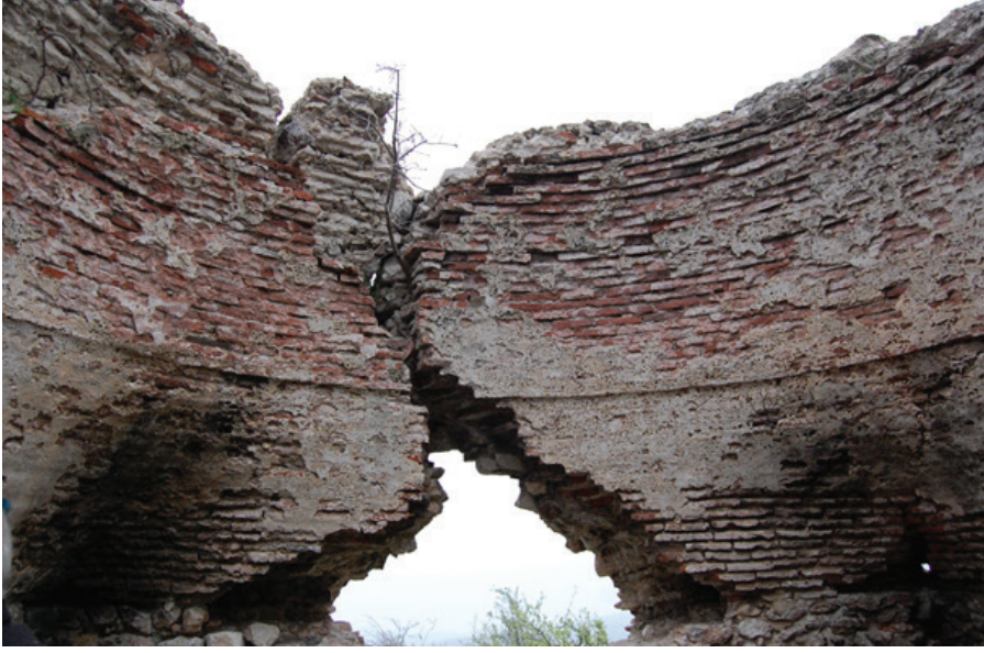
Fotoğraf-8. Eski Manyas Türbe İç Mekan Duvar Çatlakları
