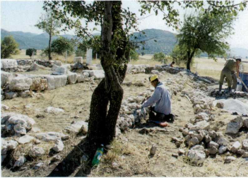
Levha 52/2- 2003 yılında Kilise'nin onarım ncesi grnm. Plate 52/2- View of the Church in 2003 before the repair work 2003.
