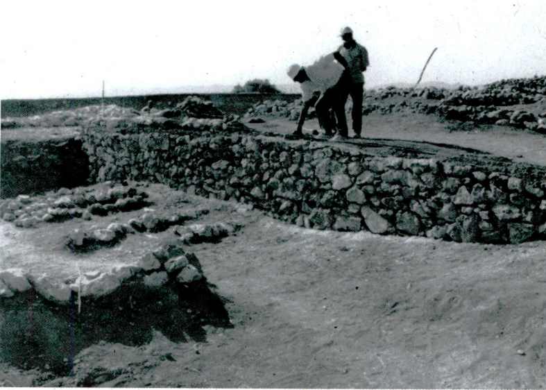
Levha 51/2- İTÇ II / 3 yapı katının 1 numaralı yapısının temelleri altına yapılan istinat/dayanak duvarı. Plate 51/2- Retaining/support walls constructed under the foundations of EBA II / 3 - House 1.
