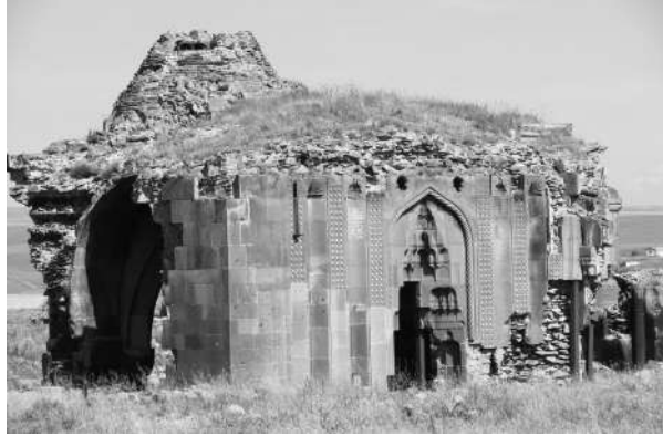
Resim 24: Kars / Ani'de Selçuklu devrinde kervansarayaya dönüştürülmüş (11. yüzyılın ilk yarısı) Havariler Kilisesi'nin doğu cephesinde, Selçuklu karakterini taşıyan taş işçiliği, içte kubbe kesiminde olduğu gibi özellikle mukarnas uygulaması ile dikkati çekiyor (Fotoğraf: Yaşar Çoruhlu, 2009).
