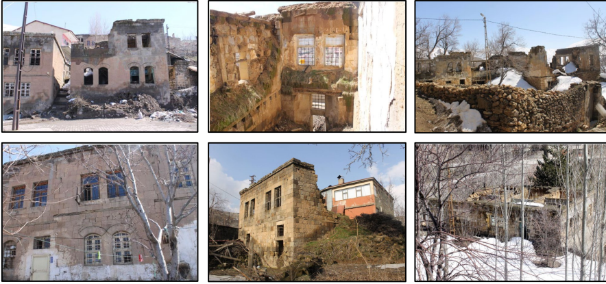
Şekil 14. Kültür varlıklarında damlardan kaynaklı bozulmalar 33
