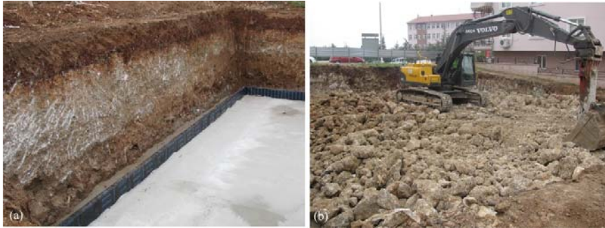
Şekil 2. Konglomera birimlerinde açılmış kazı çukurlarından (a) ve örneklemelerde kullanılan bloklardan görüntüler (b) (Views from excavation pits opened in conglomerate units (a) and blocks used in sampling (b))
