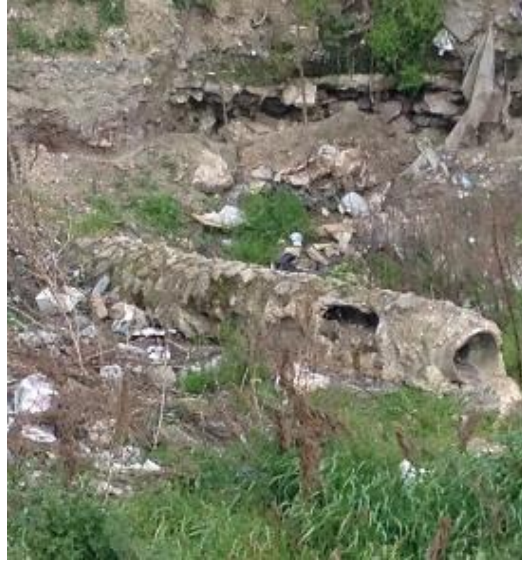
Şekil 15. Zeytinburnu Veliefendi Çeşmesi ve Namazgâhı'na ait, pişmiş toprak künklerden yapılmış özgün su kanalının tahrip olmuş hali.
