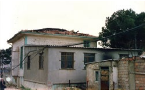
Fotoğraf 13: Namazgâh Camii'nin mihrab ve doğu cephesi yönünden yangın sonrasında, 26.09.1994 tarihindeki genel görünümü. Caminin doğu duvarına bitişik betonarme yapı, 1990'da yapılan ek bölümdür. İstanbul 6 Numaralı Kültür Varlıklarını Koruma Bölge Kurulu Müdürlüğü Arşivi.
