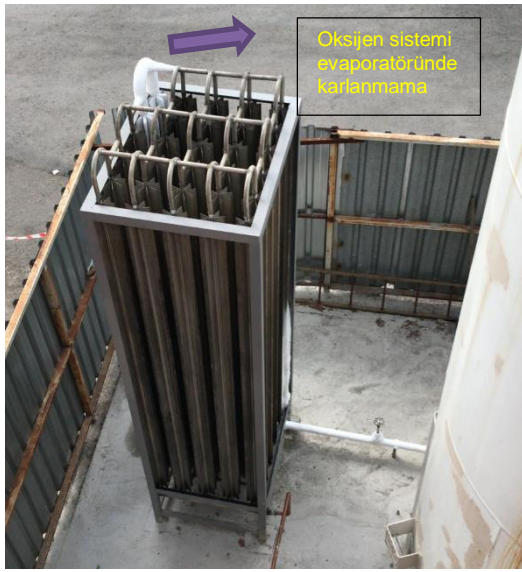
Şekil 8. Oksijen sistemi evaporatöründeki karlanma (Icing on the oxygen system evaporator)
