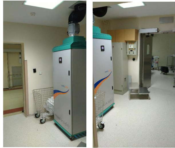
Şekil 6. Covid (+) hastalar için ayrılmış olan ameliyathane giriş holünde negatif basınçlandırmanın sağlanması (Ensuring negative pressurization in the operating room entrance hall reserved for Covid (+) patients)
