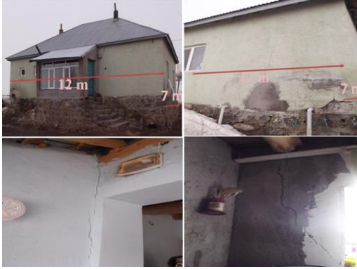
Figure 6. Damages on masonry building-4 (4.Yığma binaya ait hasarlar)
