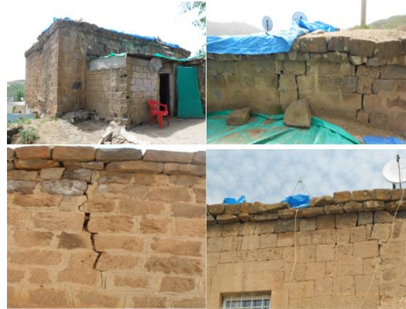
Figure 3. Damages on masonry building-1 (1.Bina hasarları)
