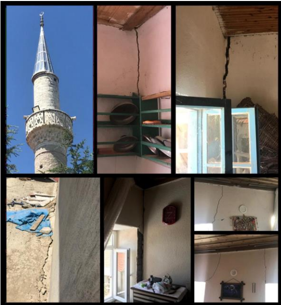
Şekil 5. Deprem nedeniyle binalarda oluşan hasarlar.
