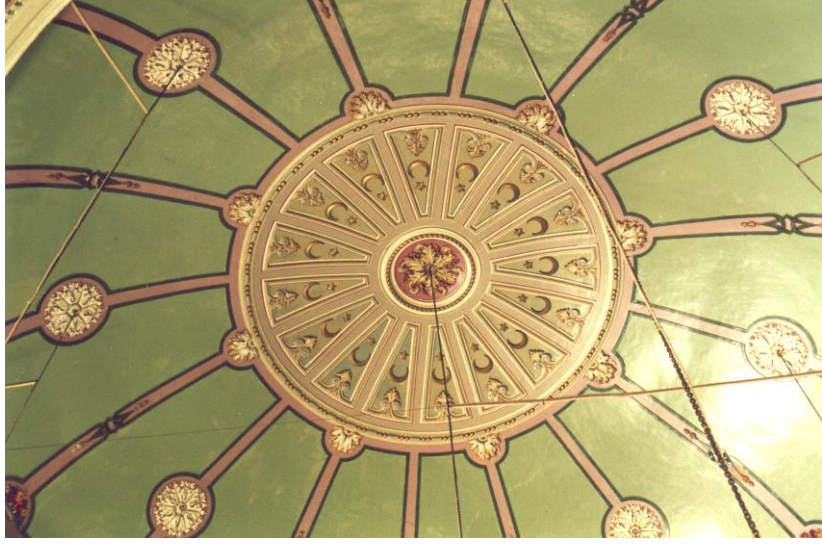
. Res. 7- Akhisar Ulu Cami. Merkezî kubbenin alçı ve kalemîşi sslemelerinden ayrıntı
