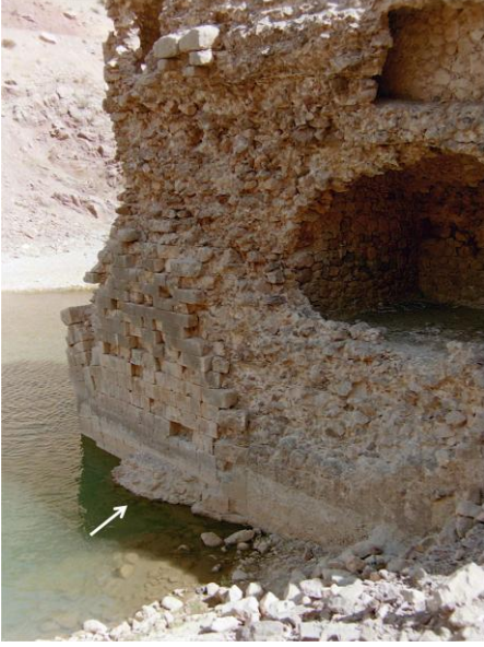
Res.11- Köprünün batı ayağının kuzey yüzü üzerindeki selyaran (okla işaretli).
