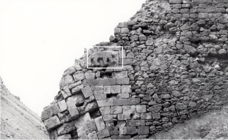
Res.12- Pısyar Köprüsü doğu ayağının güney yüzünde yer alan fil kabartması. Muhtemelen 1980'li yıllarda çalınmıştır.
