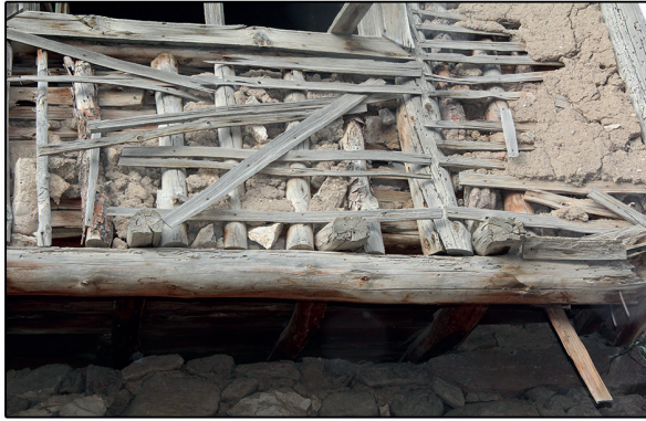
Fotoğraf 49: Çamur Harçla Sıvalı Bağdadi Çita / Mud Mortar Plastered Baghdadi Lath
