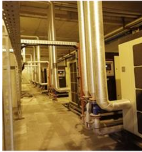
Şekil 5. Kompresör odası genel yerleşimi
