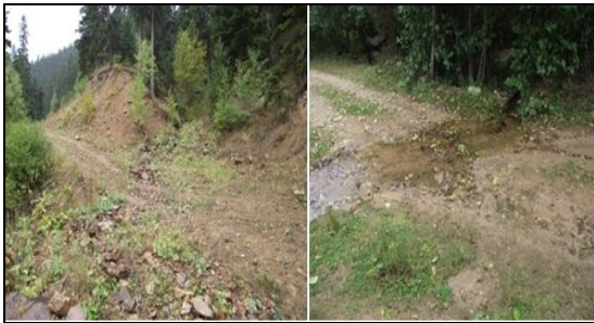
Şekil 3. Yol platformunda bozulmalar
