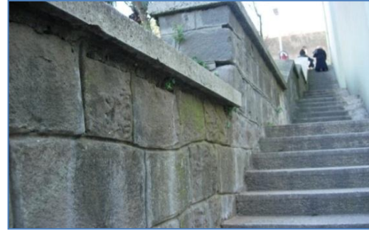
Şekil 18. Engellilerin düşünülmediği merdivenler
