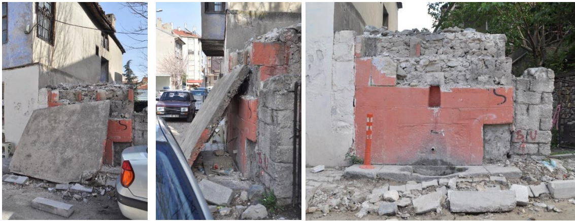
Şekil 8. Aldanzade Hacı Osman Çeşmesi kaza sonrası durumu
