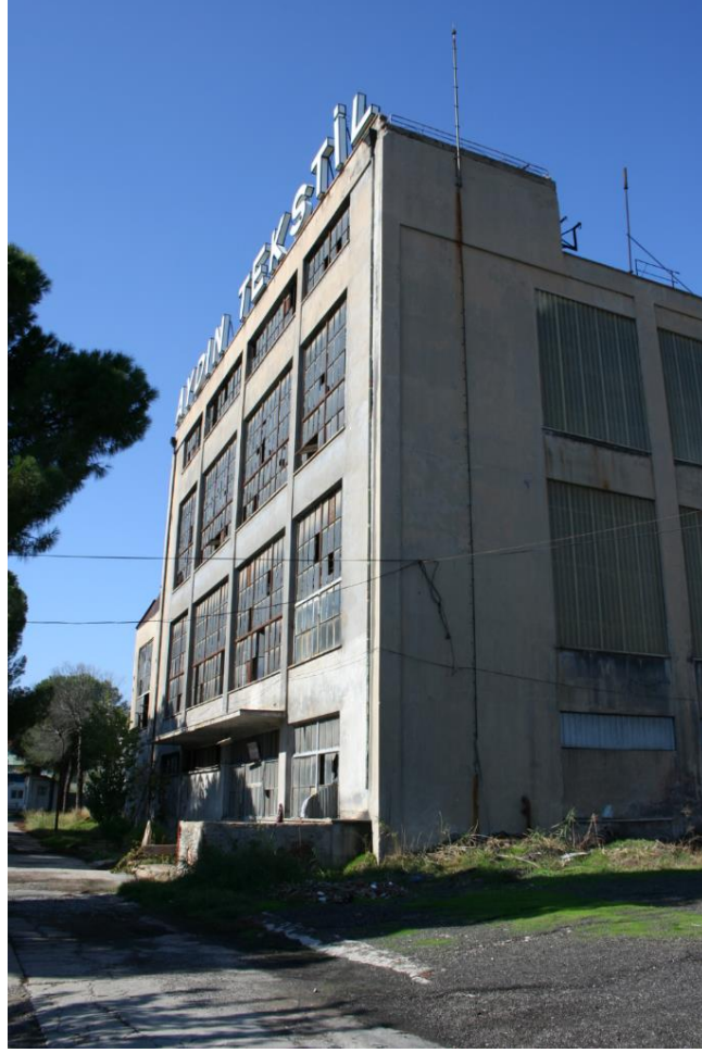
Şekil 11 Üzerinde 'AYDIN TEKSTİL' tabelası ile Kazan Dairesi, 2003. (Aydın Kültür Varlıklarını Koruma Bölge Kurulu Müdürlüğü Arşivi)
