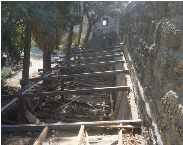
Şekil.16-1, 2, 3, 4: 1. Avlu mozaik eser sergilemesi için inşa edilen duvar-sundurma yapısı ve Amphora sergileme için inşa edilen sundurma yapısı ile taş hasarları
