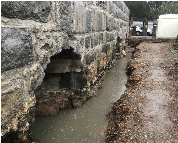
Şekil.12-1, 2, 3: Top Koruganı yapısı iç mekânda ve dış cephede yaşanan su sorunu
