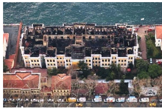
b. Yangın sonrası binadaki hasar
