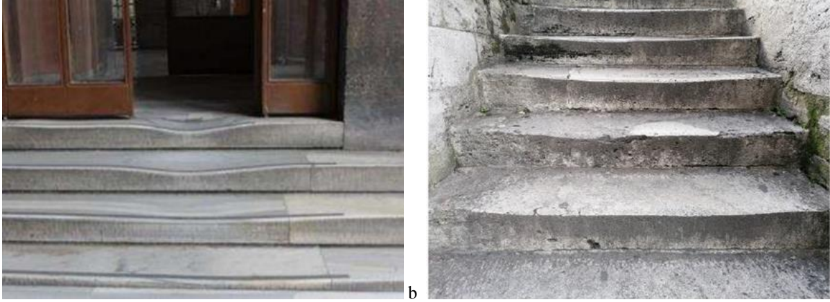
Şekil 15 a, b. Merdiven basamaklarının aşınması
