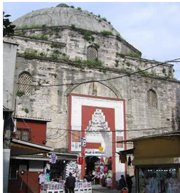
b. Kapı girişinin bakım amaçlı boyanarak yapıya zarar verilmesi
