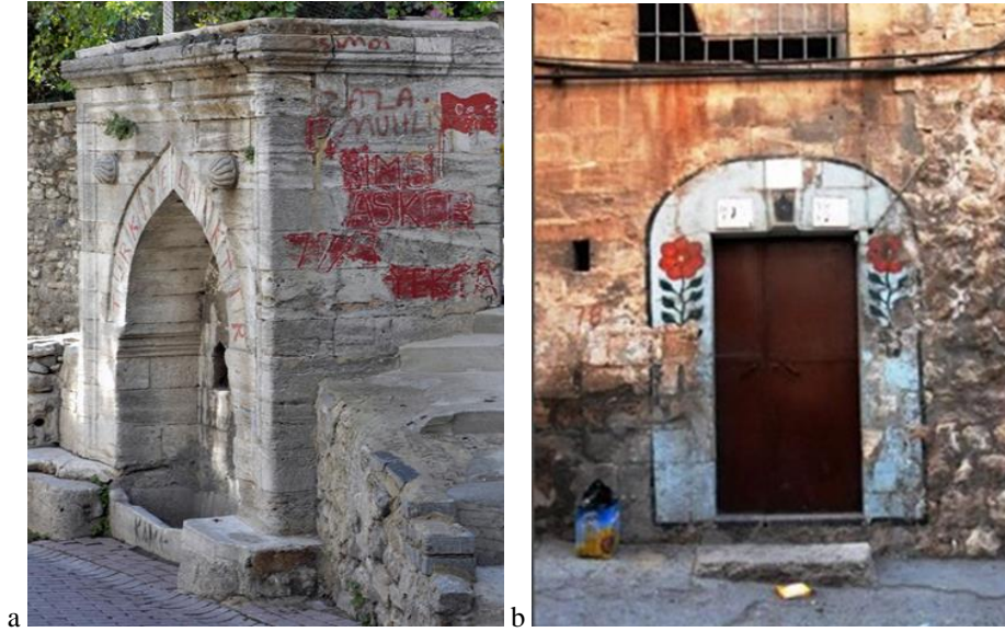
Şekil 24 a, b. Taş yüzeylerde grafiti ile yapılan hasarlar (Öcal ve Dal, 2012).
