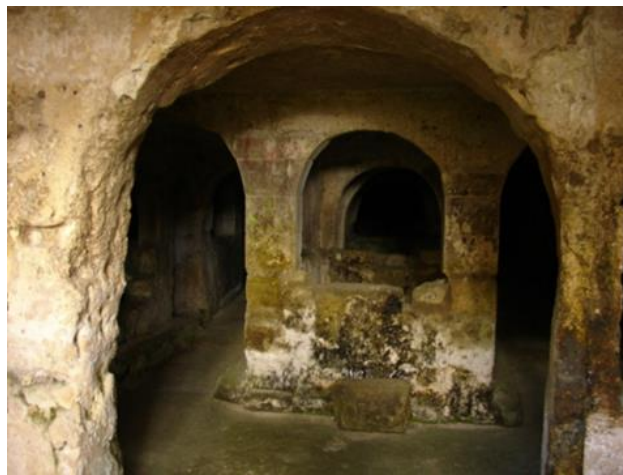
Şekil 12. Duvar yüzeyinde kimyasal değişiklik ile taşın tozlanması
