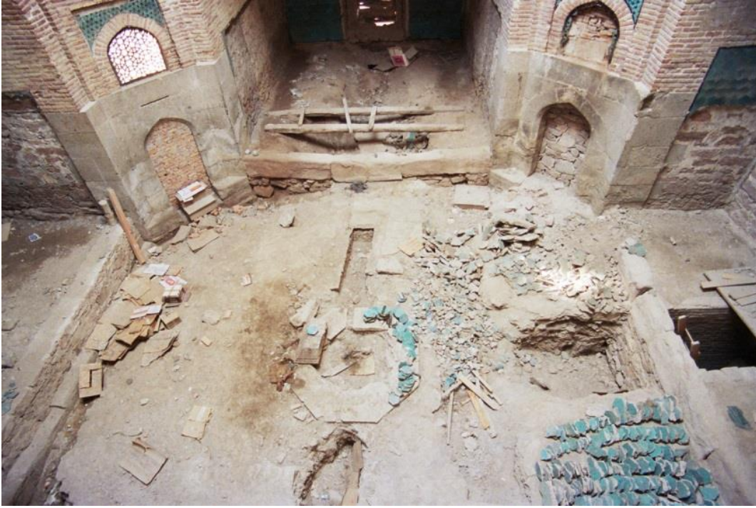
Fotoğraf 21: Hanikah ve batı eyvanı onarım öncesi.
