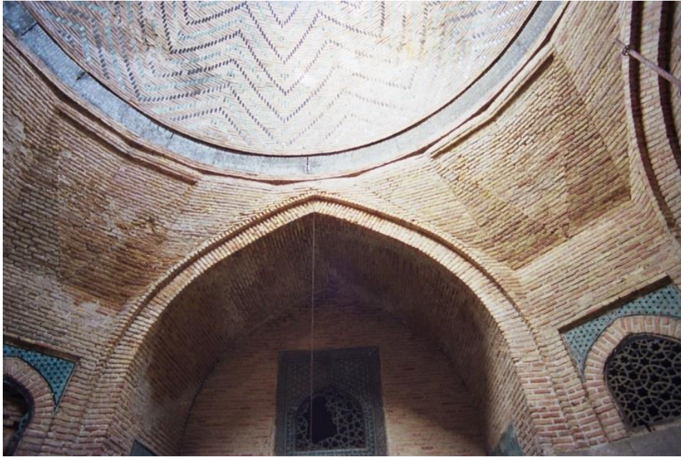
Fotoğraf 20: Kuzey eyvanı penceresi onarım öncesi. (Konya Vakıflar Bölge Müdürlüğü'nden alınmıştır)
