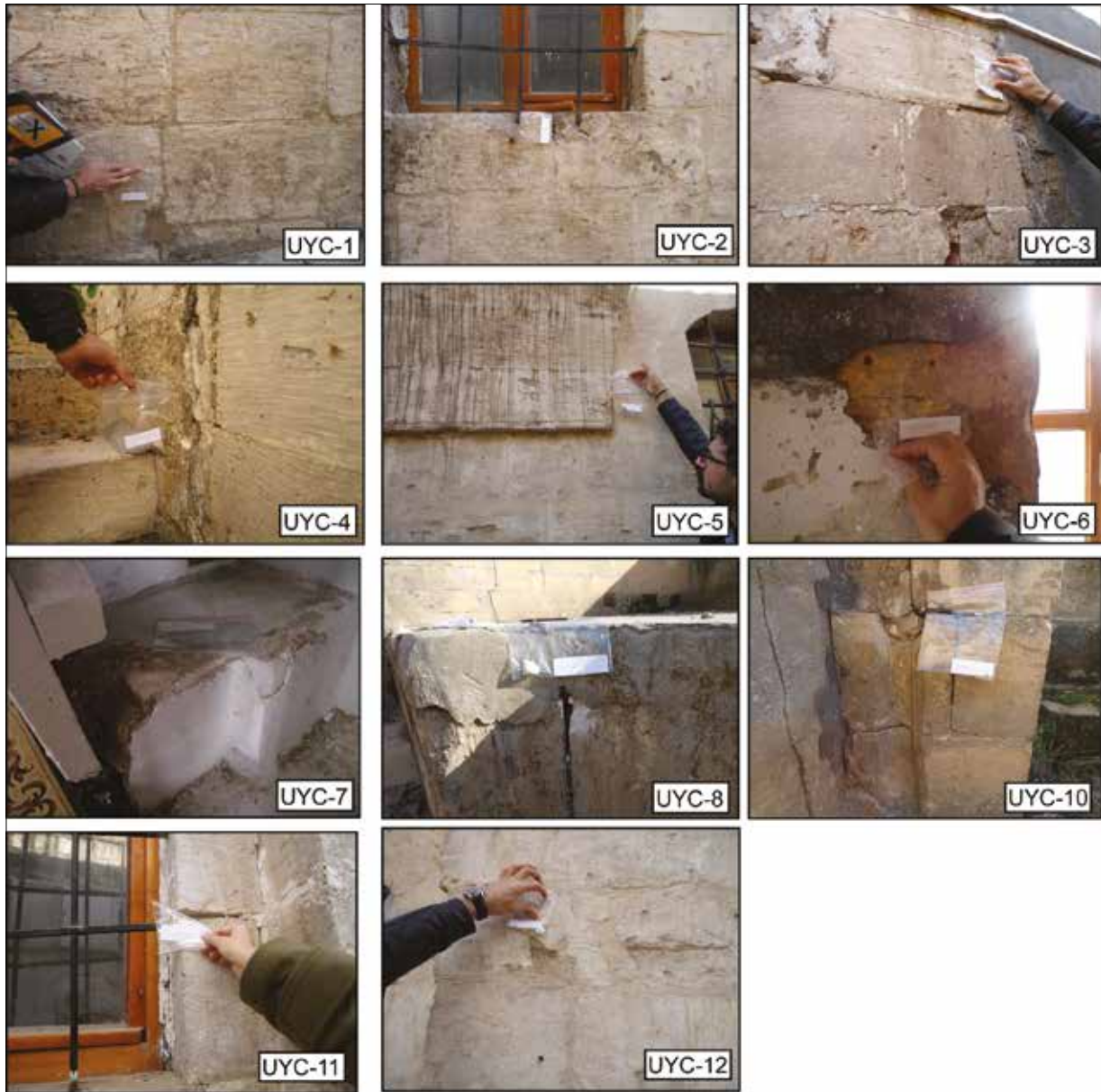
Şekil 3: Şanlıurfa Hacı Yedigâr Camii Tahrifatlı Örneklerin Alındığı Lokasyonlar / Destructive Samples were Taken Areas of Şanlıurfa Hacı Yedigâr Mosque
