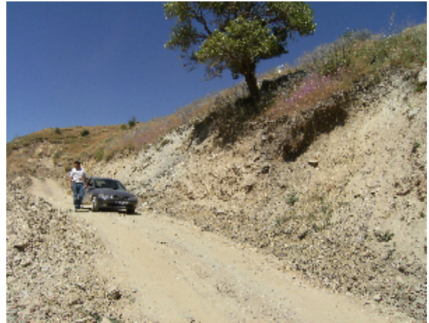
Şekil 5: Sütluçe güneyinde yol yarmasında gözlenen Heyelan Karmaşığı, bakış yönü KB.
