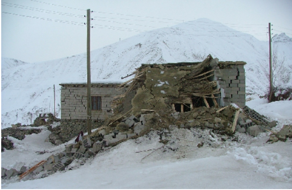
Şekil 11: Sütluçe’de depremde hasar görmüş yapılardan biri, bakış yönü GB. Figure 11: A collapsed traditional building on Sutluçe, viewed from NE to SW.
