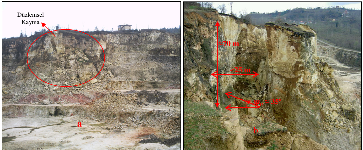
Şekil 6: Şevlerin Kayma Oluştuktan Sonraki (a) ve Yakından Görünümü (b) Figure 6. A View of the Slopes After Failure (a) and a Close View of the Failure (b)
