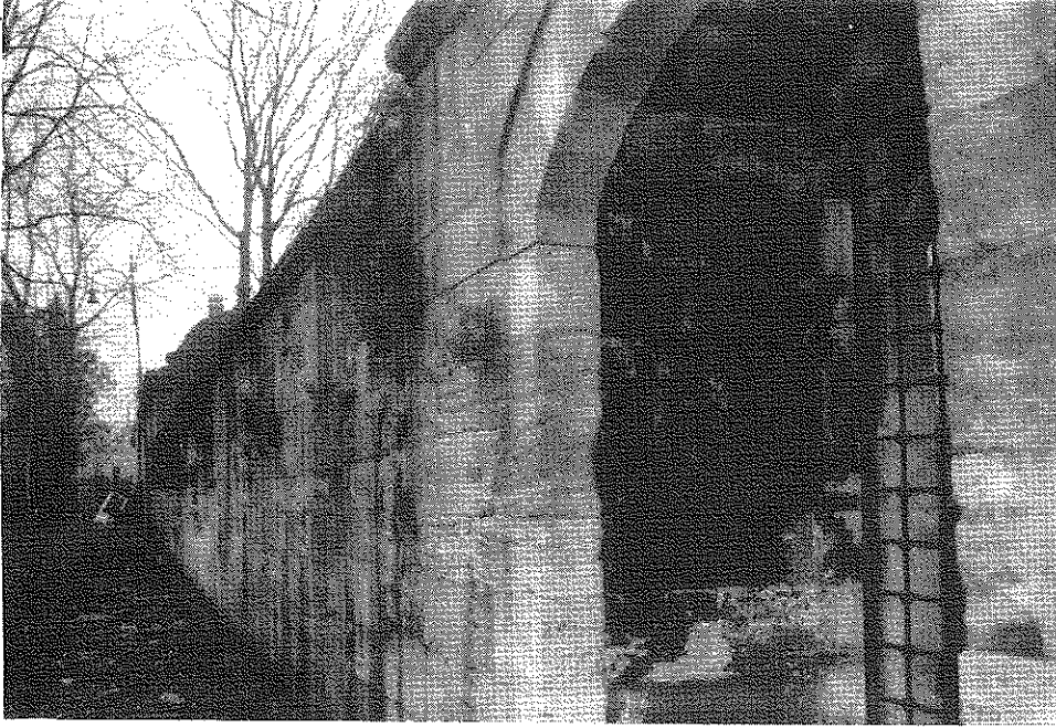
Şekil 6. Farklı özellikteki kireçtaşlarındaki ayrışma. Figure 6. Weathering of different types of limestone.
