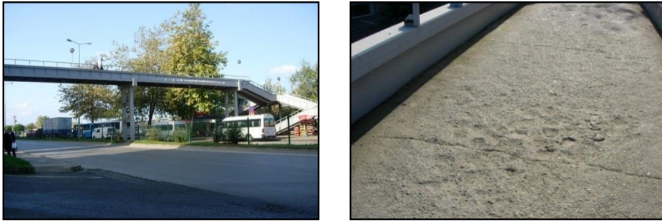
Şekil 20. Genel görünüş ve zemindeki estetik olmayan bir görüntü Figure 20. General view and image of not aesthetic on ground
