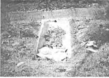
Şekil 6 : Şevlerin çöplük olarak kullanımı Figure 6: Solid wastes on the roadside
