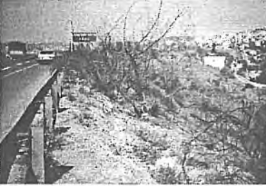
Şekil 3: Yol şevlerinde yangın Figure 3: Fire on the roadside
