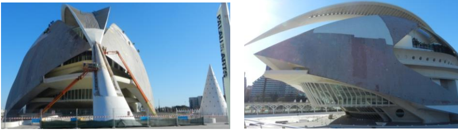
Görsel 12. Seramik kaplamalarda meydana gelen hasarlar
