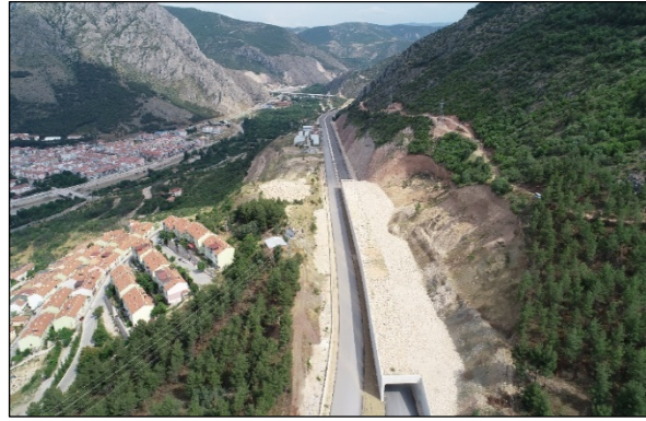
Fotoğraf 2. Amasya boğazının girişinden itibaren yapılmaya başlanan çevre yolunun yamaçtaki akma sonucu tamamlanamayan ve çözüm olarak yapay tünel yapılan bölümü.
