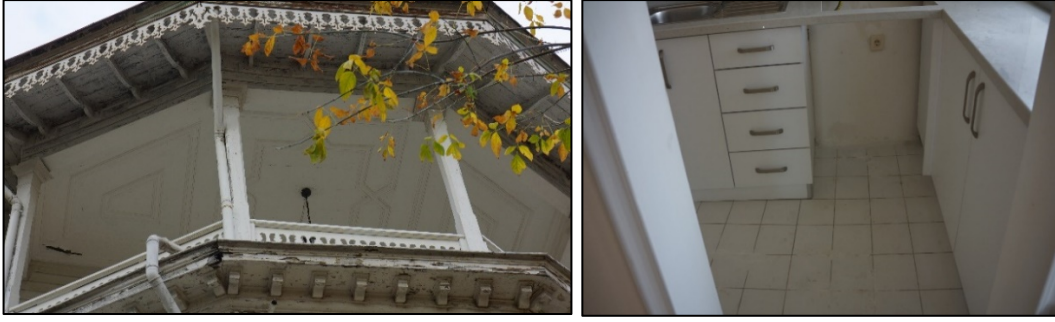
Şekil 19. Balkon ahşaplarında bozulmalar (Kaya, 2021) Şekil 20. Islak zeminlerde bozulmalar (Kaya, 2021)
