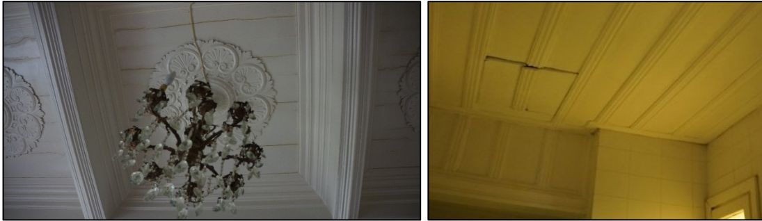
Şekil 17. Tavanlarda nemlenmeler (Kaya, 2021)
