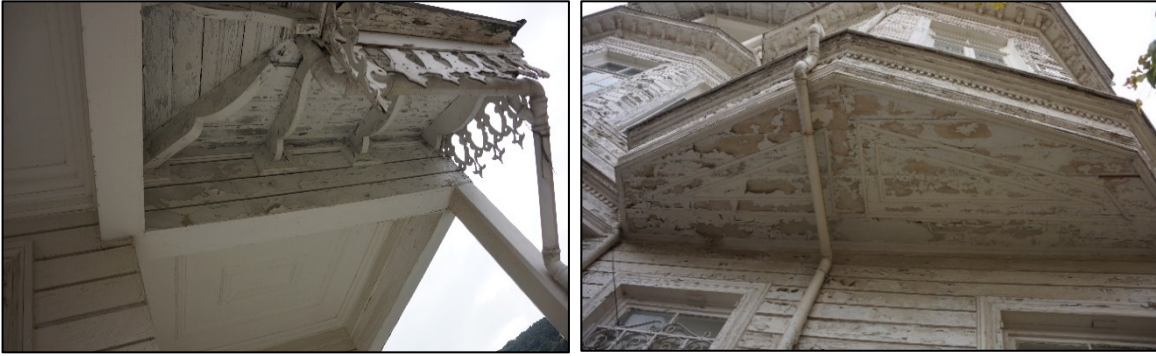
Şekil 15. Saçak süslemelerinde bozulmalar (Kaya, 2021) Şekil 16. Dış kaplamalarda bozulmalar (Kaya, 2021)
