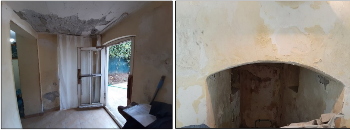
Şekil 21. Bodrum tavanlarında bozulmalar (Kaya, 2021) Şekil 22. Duvarlarda bozulmalar (Kaya, 2021)
