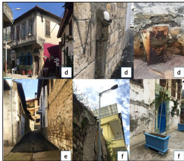
Şekil 4. Yapısal materyaller üzerinde gözlemlenen sorunlar
