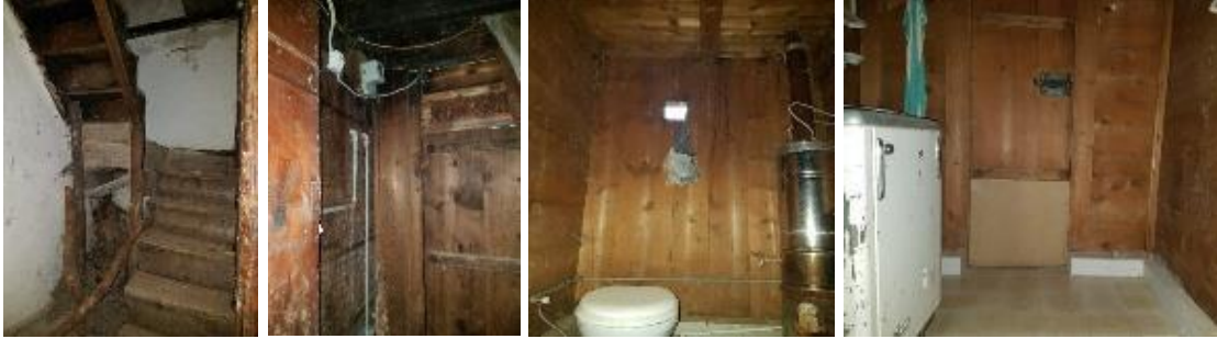
Şekil 13. Çatı katıyla bağlantıyı sağlayan merdiven holü (Sol iki), ıslak hacmin doğu ve batı duvarları
