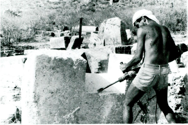
Res. 1 — Onarım amacıyla mimari elemanın ortasının oyulması (Perge).
