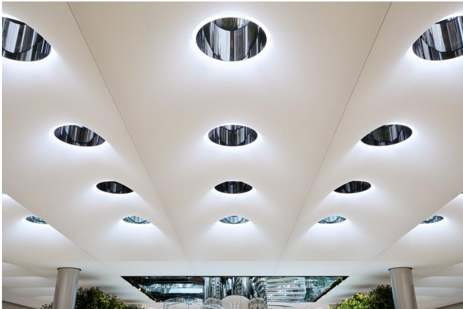
Şekil 13: Tavandaki tepe pencerelerinden gün ışığının dağılımı ve etrafını çevreleyen sensörlü LED armatürler (URL-7)
