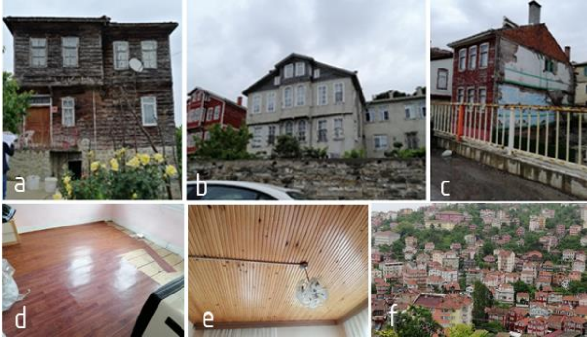
Şekil 16. a) Cephede pencere kapatılması- kapı açılması ve özgün giyotin pencerenin pvc ile değiştirilmesi, b) Cephedeki ahşap kaplamaların sıvanması ve niteliksiz ek yapılması, c) Yapının bitişiğindeki yıkım faaliyetinin yapıya etkisi, d) Ahşap döşemelerin üzerine pvc kaplama yapılması, e) Özgün çıtalı ahşap tavanların yerine ahşap lambri yapılması, f) Silüette geleneksel konut dokusunda algılanan betonarme apartman yapıları
