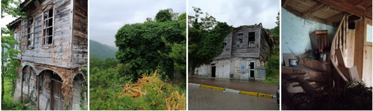
Şekil 15. Cephelerini kaplayan bitkilerin etkisiyle görünmez hale gelen yapılar, bakımsızlıktan taşıyıcı sistem, iç mekân ve cephelerde meydana gelen hasarlar
