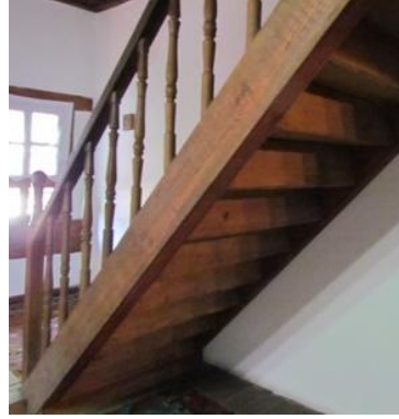
Şekil 20. Merdiven (Figure 20. Example of staircase)
