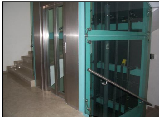
Şekil 9. Merdiven boşluğundaki asansör [Özçetin, Z. arşivi] (Figure 9. Stair Lift cavity) [Özçetin, Z. archive]
