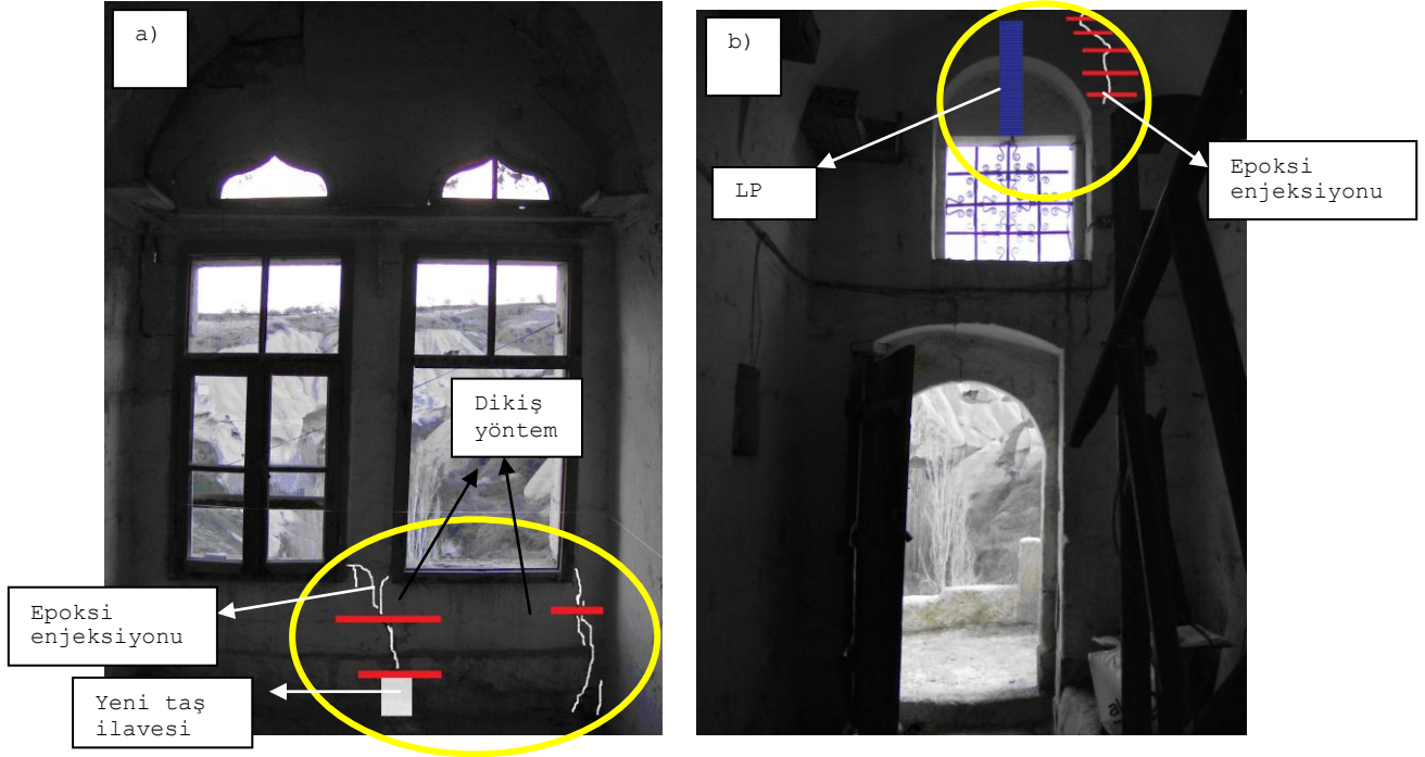
Şekil 18. Mevcut yapıdaki hasarlara uygulanabilecek onarım ve bölgesel güçlendirme yöntemleri
