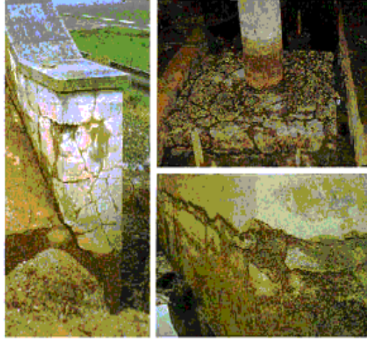
Şekil 3. ASR'den kaynaklanan çatlaklara ilişkin görünüşler [19] (Figure 3. Examples views of cracks caused by ASR [19])
