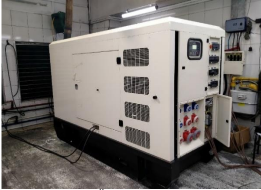
Şekil 6. Üretilen jeneratör seti
